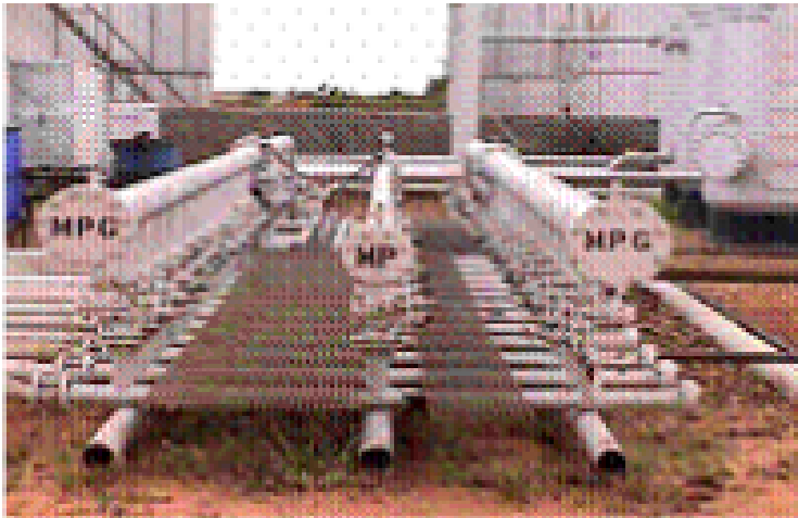
Figura 16. Múltiple de producción de una estación de flujo.
